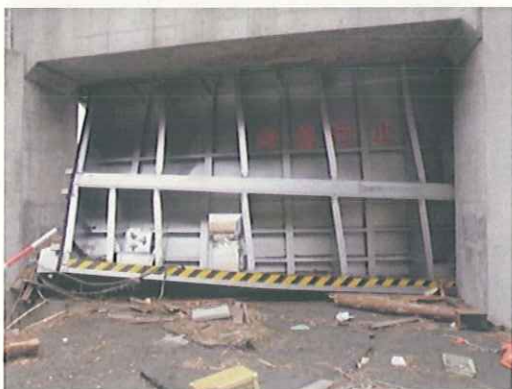
陸閘が陸側に破損 (写真:宮古港海岸高浜地区)
