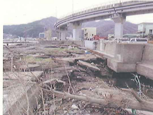
海側が洗掘 (写真:釜石港海岸須賀地区)
