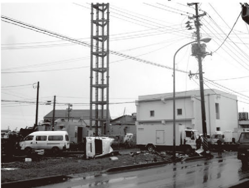
震災2週間後の石巻波波ビル NTT 移動電源車による電力供給
